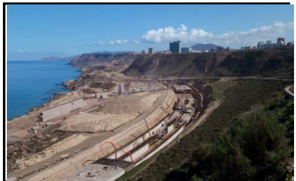
Falso Túnel – Ejecución de cimentación de la losa y hormigonado de hastiales y cubierta
